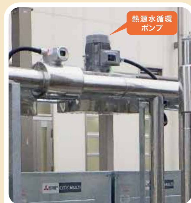
熱源水循環ポンプ
