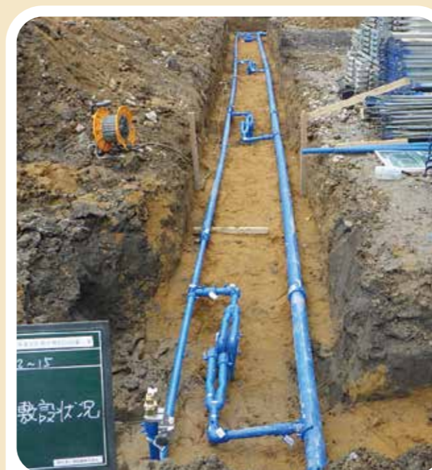
地中熱配管状況
