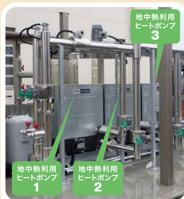
地中熱利用ヒートポンプ
